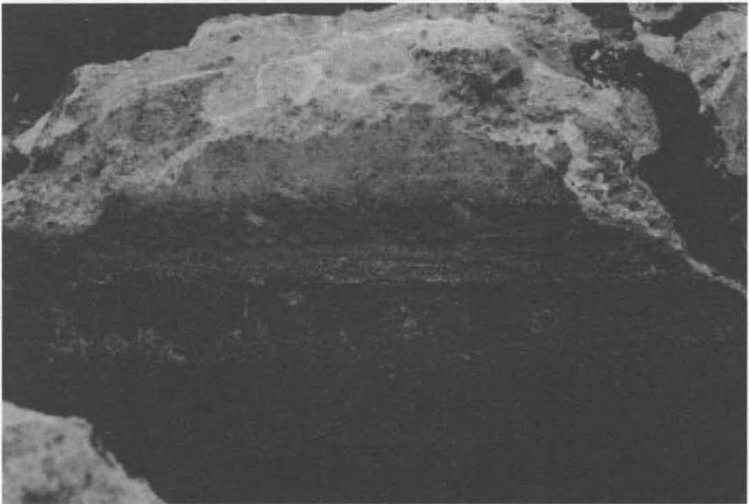
Foto 1.- Detalle de las costras adheridas a la pared del acueducto.
