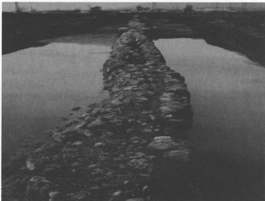
Foto 2.- Reptación e hidromorfía en el acueducto de Valdepuentes.
