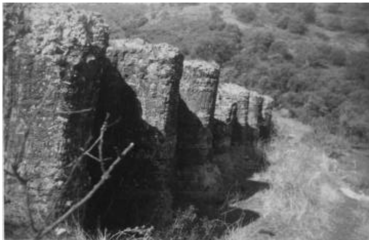
Fig. 144. Planta, alzado y foto de detalle de los contrafuertes de la cisterna del 38 Cerro del Cobre, ya derruida.
