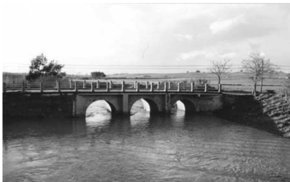
Lám. 12: El puente viejo del Guadalmezán. Sobre él la carretera de Primo de Rivera (¿y la Via Augusta?).
