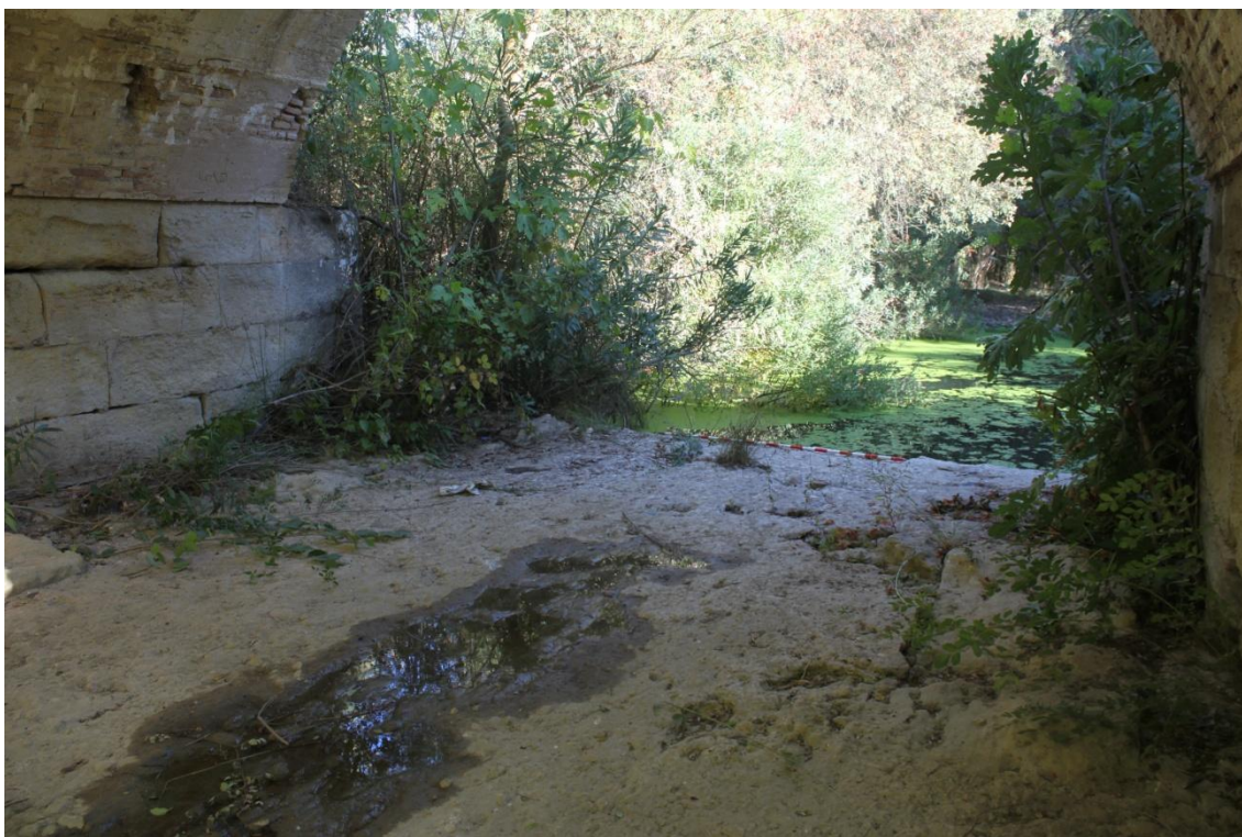
Fig. 24. Capa de hormigón que ha reemplazado a la mayor parte del zampeado a su paso por el vano central.
