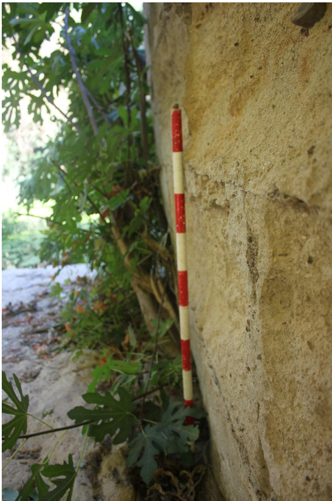
Fig. 43. Desgaste de la cara externa de algunos sillares.
