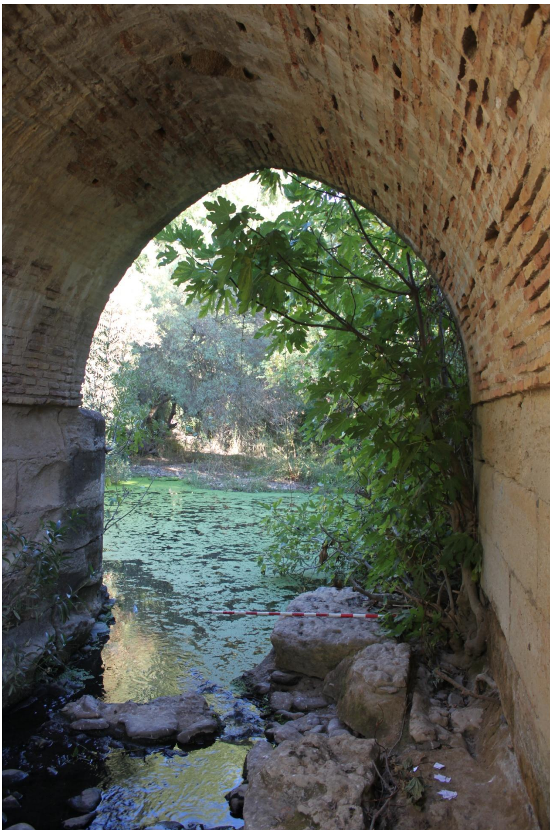
Fig. 46. Efecto de la erosión fluvial en el zampeado del arco occidental.
