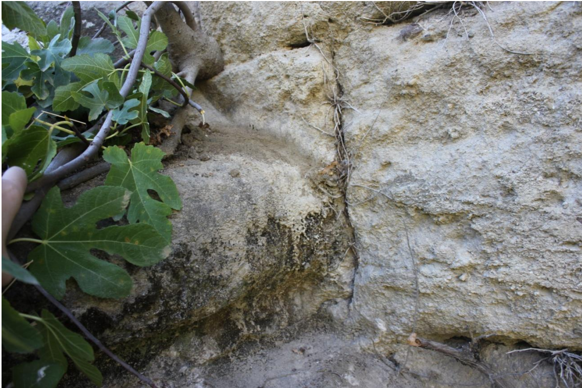
Fig. 40. Daños provocados por una higuera silvestre en el tajamar occidental (aguas abajo)
