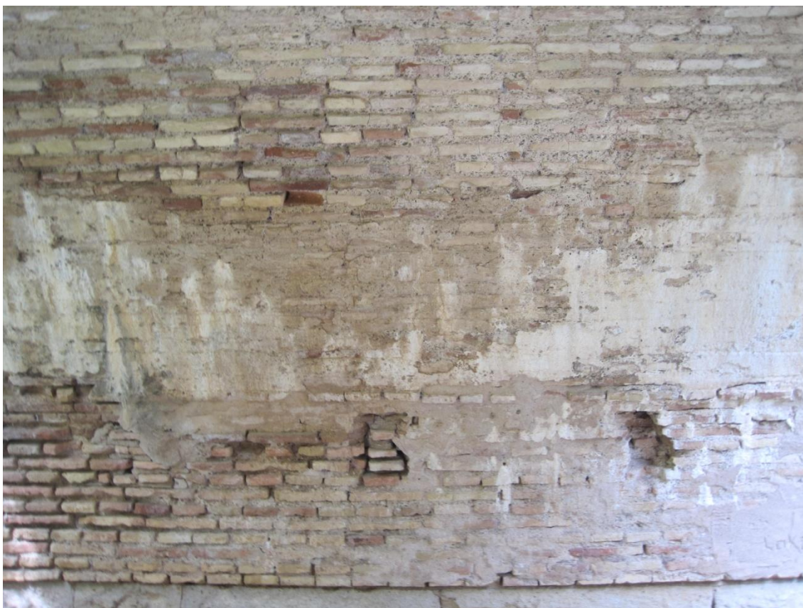
Fig. 13. Capa de argamasa y cal que recubre el intradós de los arcos.
