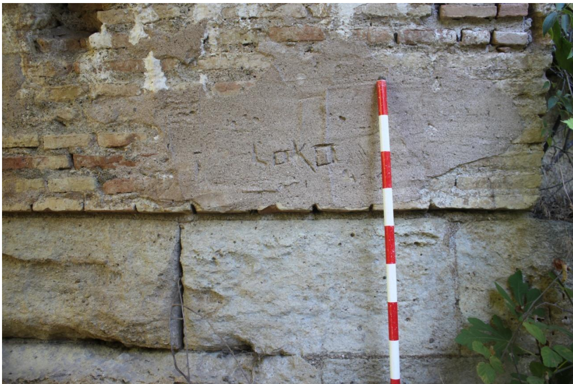
Fig. 30. Parche de cemento en el intradós del arco central.
