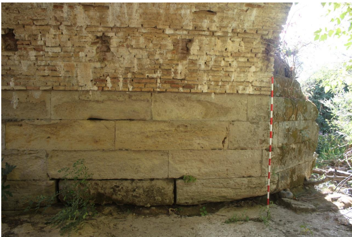
Fig. 15. Tajamar occidental (aguas arriba).
