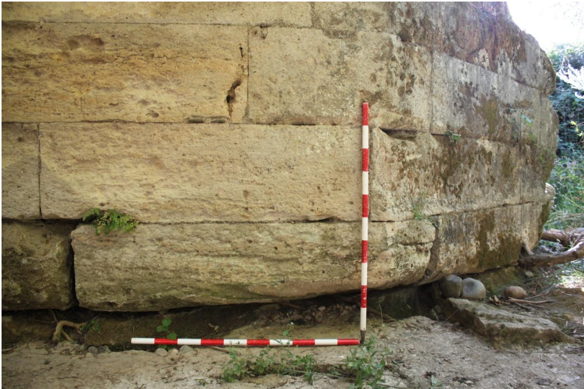
Fig. 44. Efecto de la erosión fluvial en el pilar occidental.
