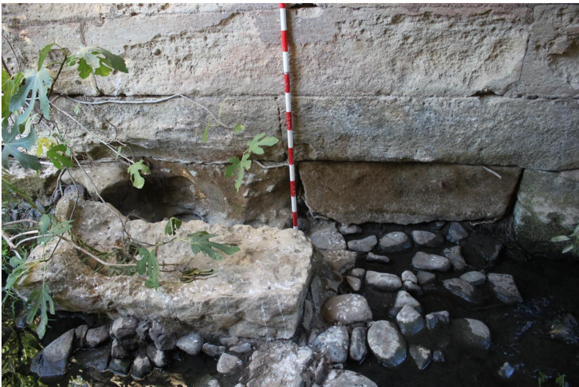
Fig. 45. Efecto de la erosión fluvial en el zampeado del arco occidental y en el pilar occidental.
