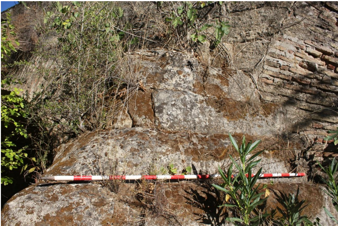
Fig. 41. Daños provocados por la vegetación en el tajamar occidental (aguas arriba).
