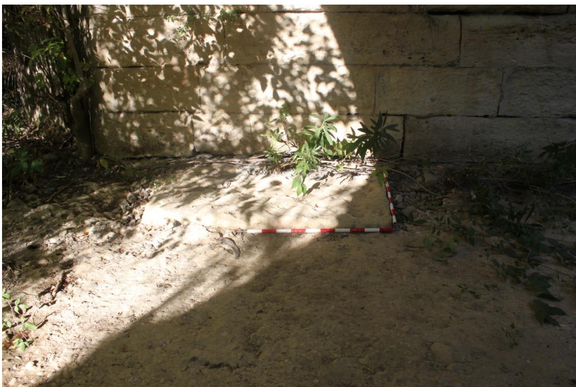
Fig. 29. Capa de hormigón que sustituye al zampeado original del arco central. Tan sólo se conservan algunos sillares del zampeado original.
